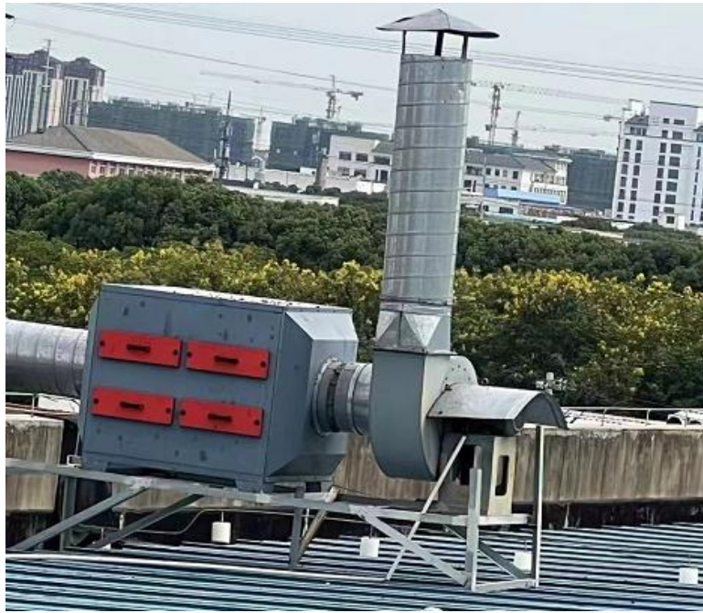
图 10-5 废气处理设备
