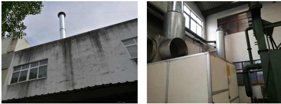
图 3-3 P1 排气筒废气处理设施图
